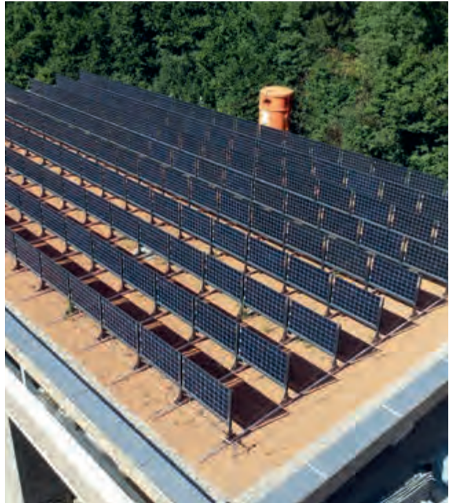
Abbildung 4: Die PV-Anlage soll mit genügend Abstand zum Dachrand hin aufgestellt werden ( \geq 60 cm), Quelle: reech gmbh
