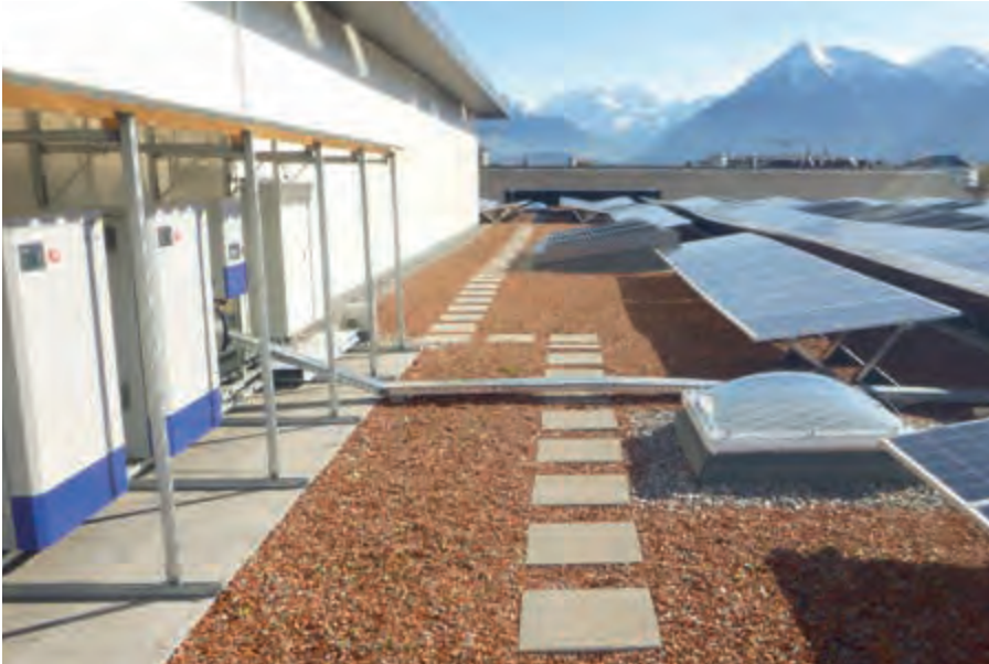
Abbildung 8: Kabelführung PV-Anlage zu Wechselrichter, Quelle: contec
