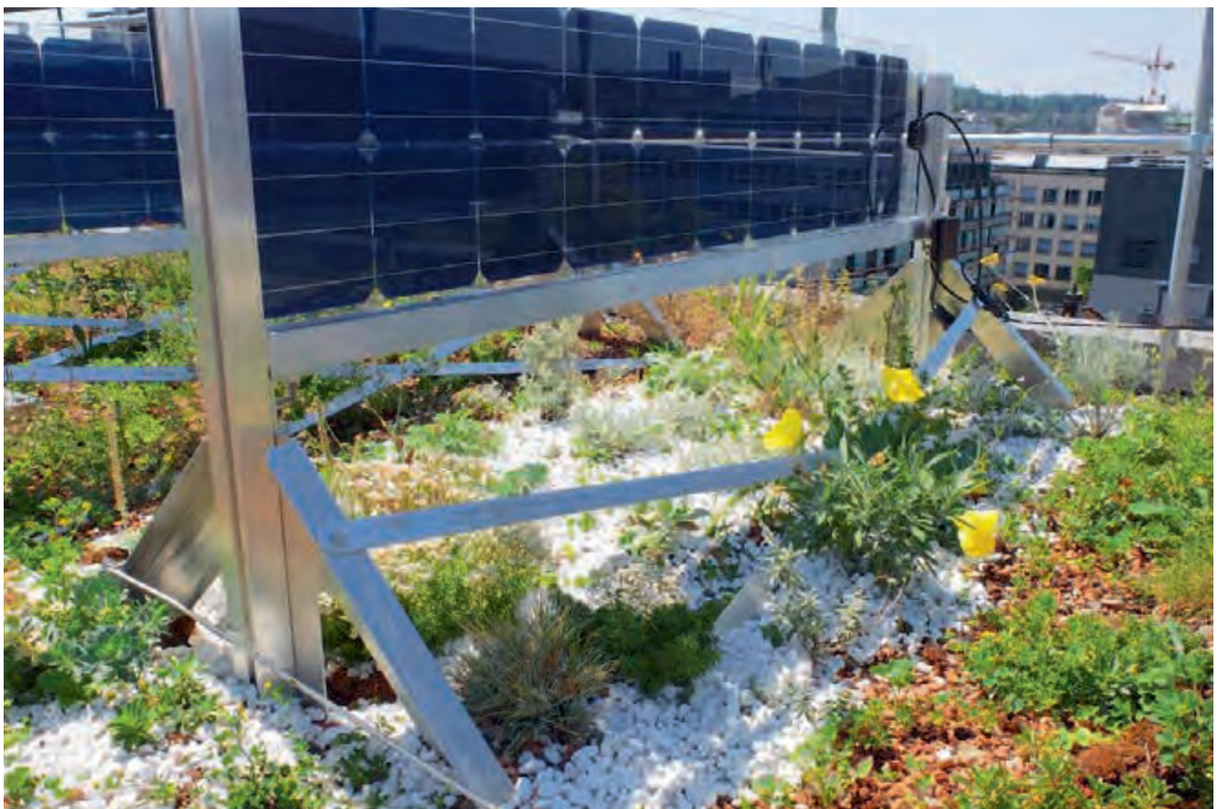
Abbildung 18: Testanlage der ZHAW, Quelle: Solarspar
