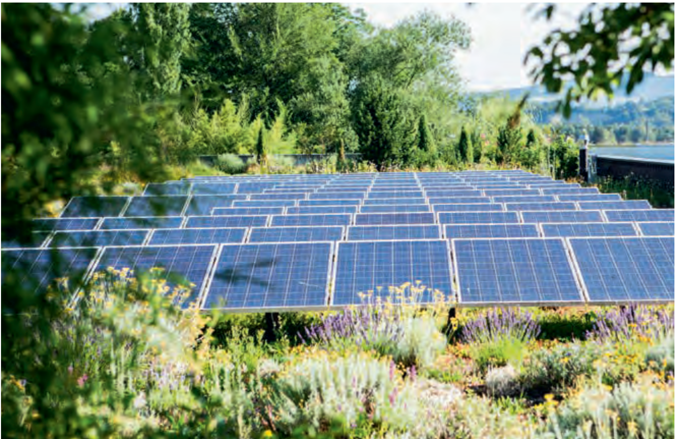
Abbildung 19: Intelligente Lösung in der Kombination von intensiver und extensiver Begrünung, zusammen mit einer Photovoltaik-Anlage, Quelle: contec
