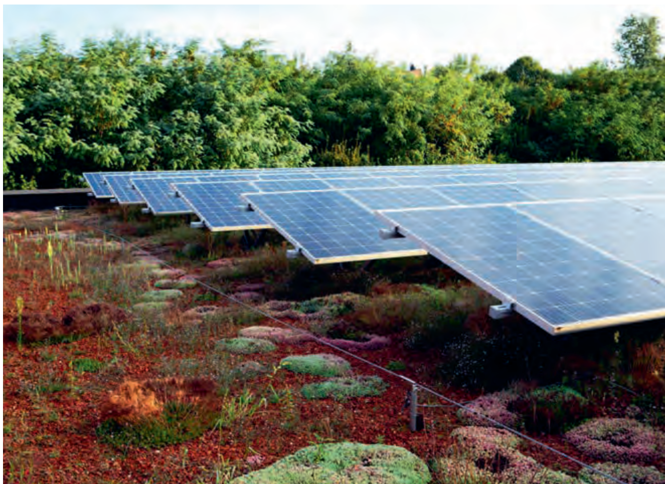
Abbildung 1: PV-Anlage kombiniert mit Extensivbegrünung, Quelle: contec
