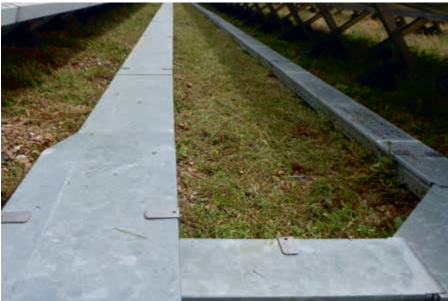
Abbildung 9: Kabelführung zwischen den PV-Modulen, Quelle: contec
