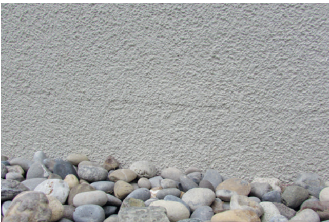
Abb. 2 Abzeichnung der Sockeldämmplatte beim Materialübergang.
